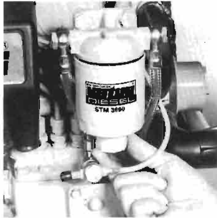
Wasserabscheider entleeren. Purge du séparateur d'eau.
